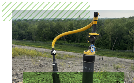
Pozo de captura de gas en el vertedero de LRS en Atkinson, Illinois.
